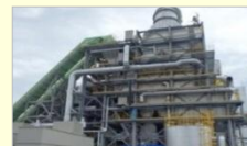
仮設焼却施設
