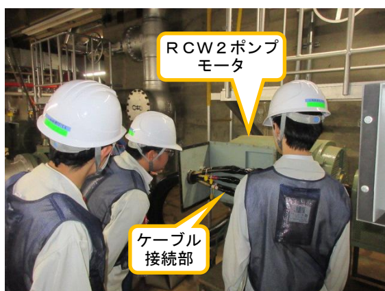
(写真5) 県職員による1号機原子炉補機第2中間ループポンプ(RCW2ポンプ)のケーブル接続部の確認状況
