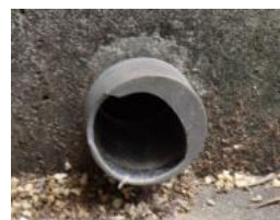
排水溝の蓋の破損
