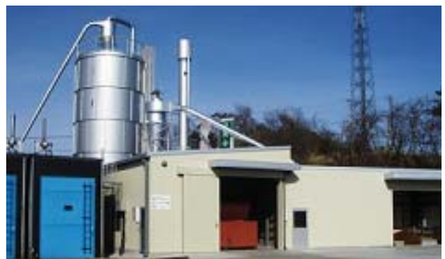
(上記写真は「木屑炊きボイラー」)
