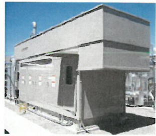
ガスエンジン (240kW)
