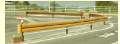
木製ガードレール
