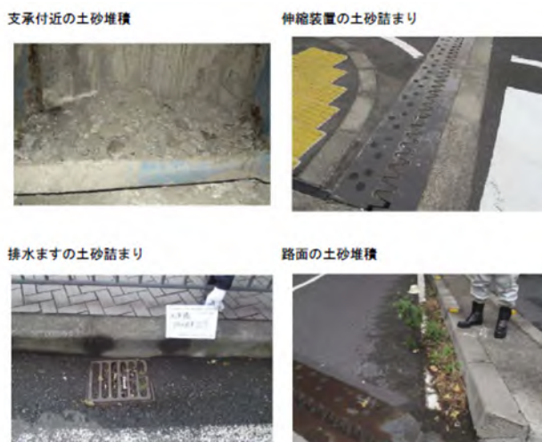
図 4.11 土砂堆積・土砂詰りの状況
