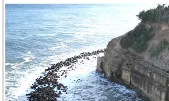
消波ブロック沈下箇所
