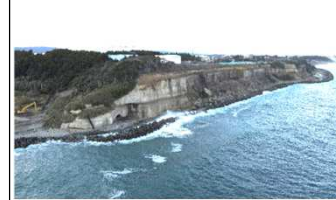
消波ブロック決壊箇所
