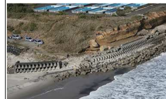
護岸被災箇所
