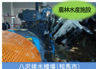
八沢排水機場（相馬市）
