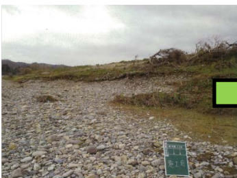
被災後の状況
