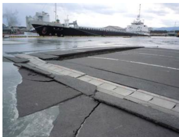
震災時には施設破損のほか、液状化の発生がみられました。
