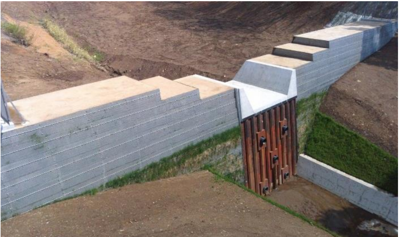
【土木】砂防堰堤工事大高内沢地区（白河市）～土石流などの土砂災害から生命、財産を守るための砂防工事
