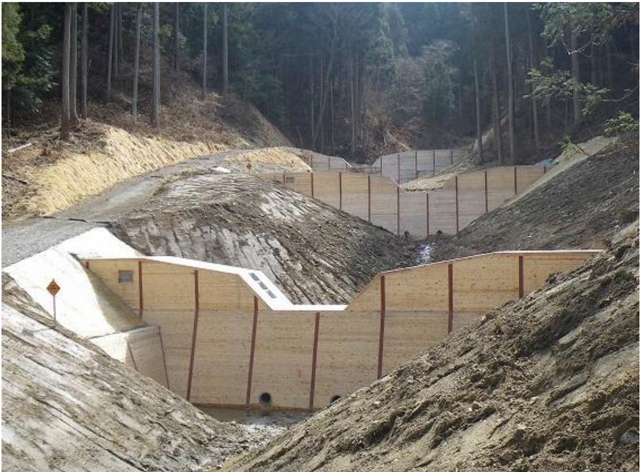
【森林】西山地区治山ダム工（矢祭町）～木製残置型枠を使用した谷止工
