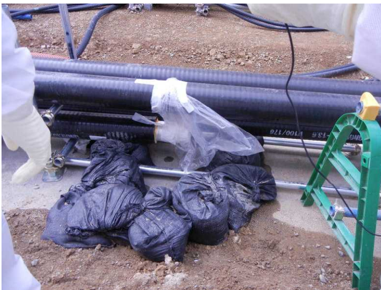
○J6エリア移送ラインでのALPS処理水の漏えいについて（漏えい現場）
