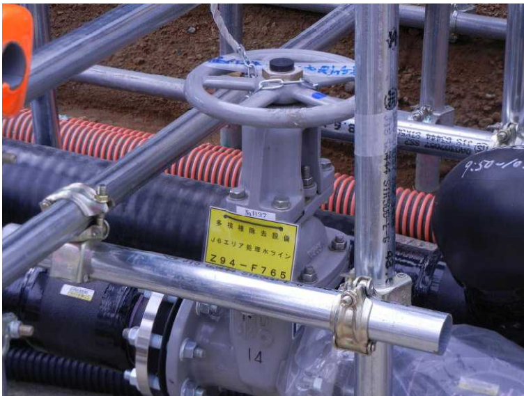
○J6エリア移送ラインでのALPS処理水の漏えいについて（誤った手順書で開操作した弁）
