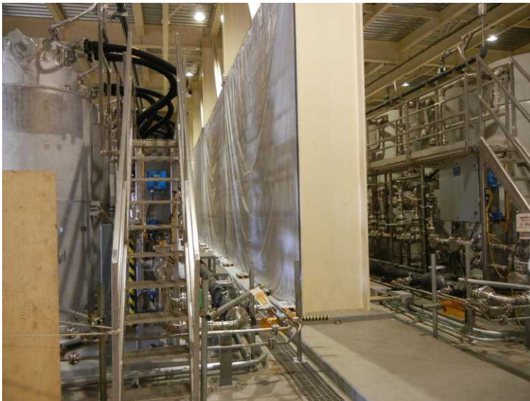
○R O 濃縮水処理設備 (飛散防止シート)
