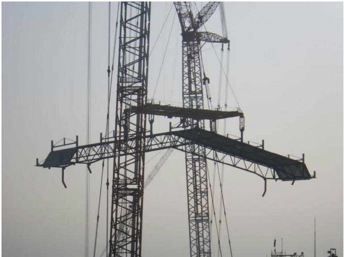
③ クレーンで屋根パネルを吊り、移動する様子。(午前6時50分)
