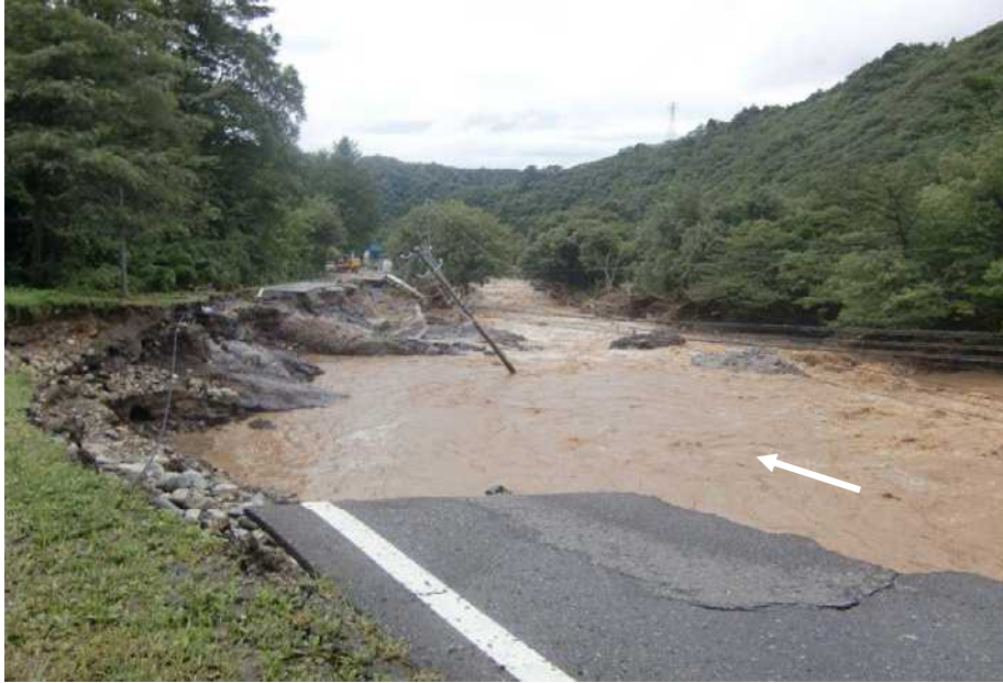
道路被災状況(平成27年9月10日撮影)
