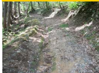
わだち掘れがひどい箇所
