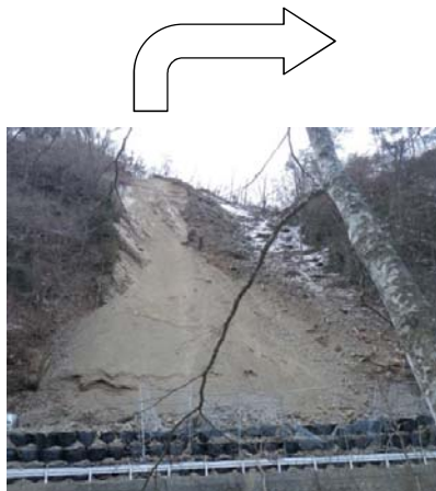
法面の崩落状況(平成23年3月)
