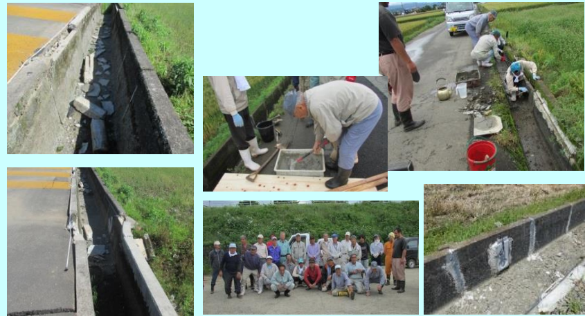
農地周りの水路の被災状況 活動組織による被災水路の応急措置や復旧
