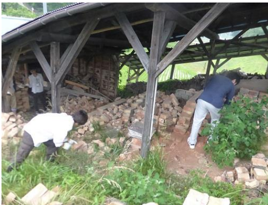
崩れた窯の様子を確認
