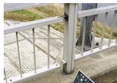
高欄の継手部の破断の例
