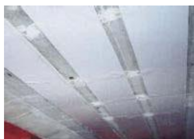
繊維シートから遊離石灰が生じている例
