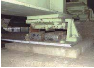
支承ローラーの脱落の例
