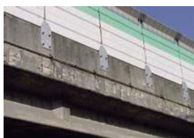
地覆に生じた剥離の例
