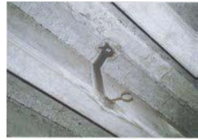
排水管の脱落の例
