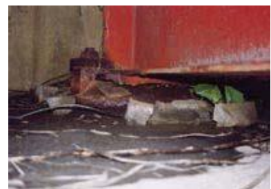
沓座モルタルの損傷の例
