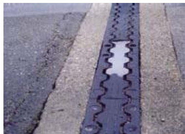
伸縮装置のゴム材に欠損が生じた例
