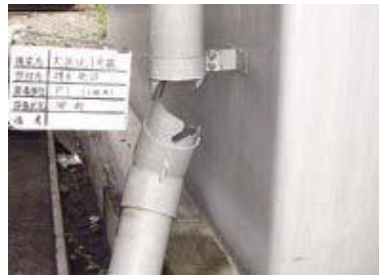
排水管の破損の例
