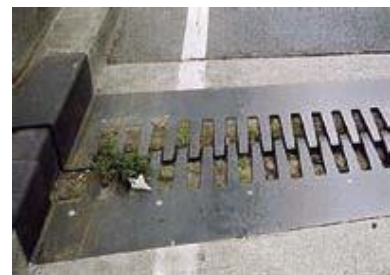
伸縮装置の遊間に土砂詰りが生じた例
