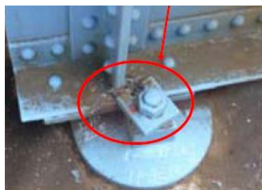
ピンチプレートの損傷（線支承）
