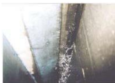
伸縮装置から漏水が生じた例
