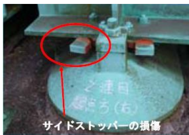
サイドストッパーの損傷（線支承）
