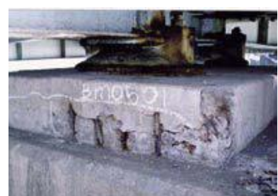
台座コンクリートの損傷の例
