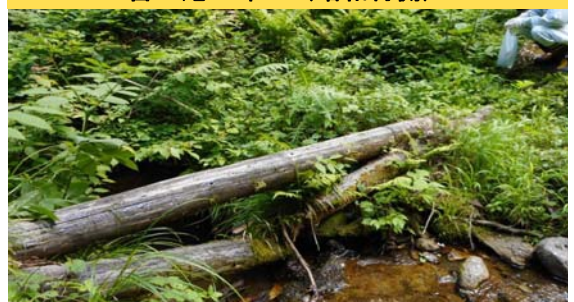
丸木橋が折れている箇所
