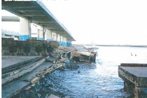
松川浦漁港(被災状況)
