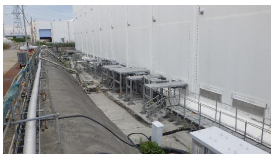
(写真1-3) 建屋西側 RO濃縮水移送配管・増設ALPSからの炭酸ソーダ供給配管等が敷設されていた。
