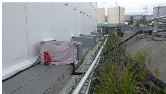
(写真1-2) 建屋北側 水の移送配管はALPS処理水移送配管やろ過水移送配管等が敷設されており、さらにケーブル類も敷設されていた。
