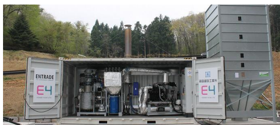
小型木質ガス化熱電併給ユニット （スパホテルあぶくま（西郷村））
