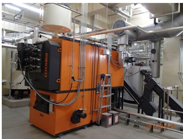
木質チップボイラー（西会津小学校（西会津町））
