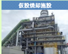
仮設焼却施設
