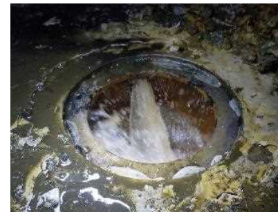
流入が確認された床ファンネル
