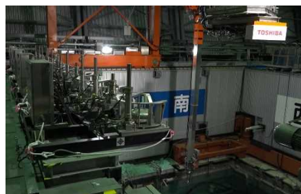
オペレーティングフロアの様子
