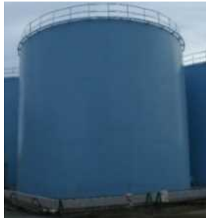
溶接型タンク
