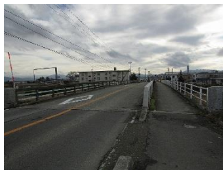
②補修箇所の確認
