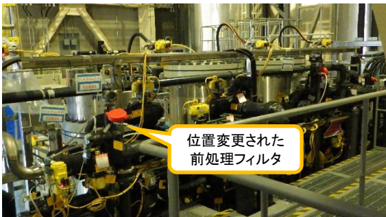
(写真3) サブドレン他浄化設備 (A系)
