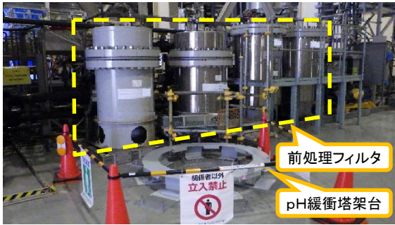
(写真4-2) サブドレン他浄化設備 (B系)
