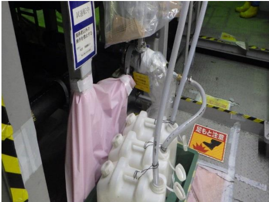
(写真4) 青い掲示に試運転中と記載されている。
