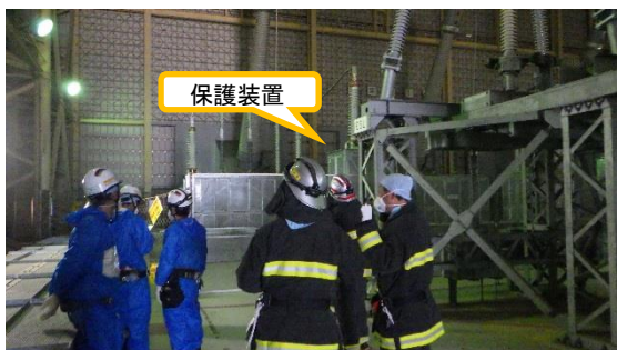
（写真1－1） 現場の状況（10時13分頃撮影） 黒煙の発生は止まっていた
