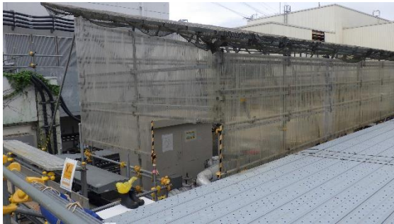
(写真1-1) 中継タンクNo.4設置箇所の状況 (雨除けカバー内部にタンクが 据え付けられている。)
