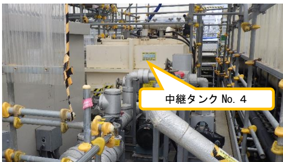
(写真1-2) 中継タンクNo.4の状況
