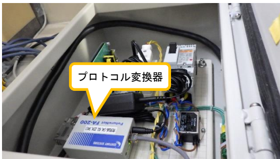
(写真1-2) ボックス内部の状況
