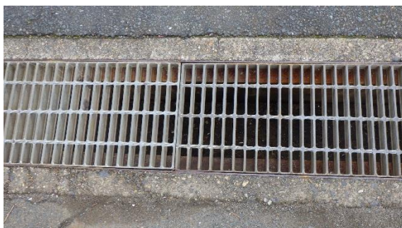
(写真2) 水が流入した側溝の状況
