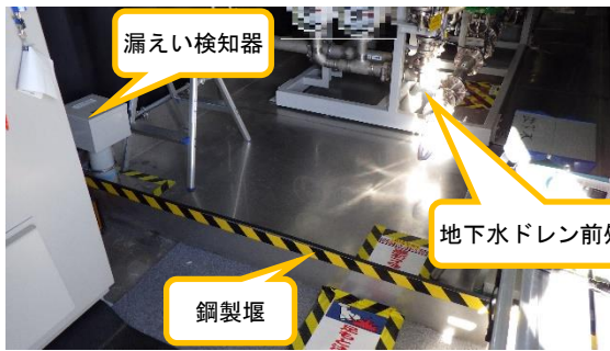
(写真1-2) 地下水ドレン前処理装置コンテナ内の 状況 (南側から撮影)
