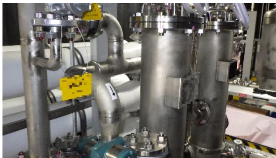
(写真2) 地下水ドレン前処理装置の一部 (保安 フィルタ) の状況
