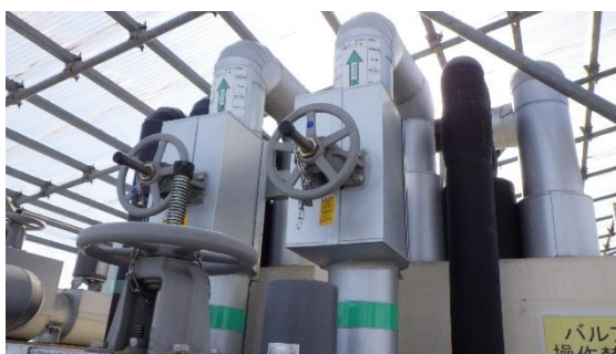
(写真3-2) 地下水ドレン中継タンクAの配管の状 況
