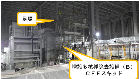
(写真2-1) 増設多核種除去設備 (B) C F F スキッド外観の状況
