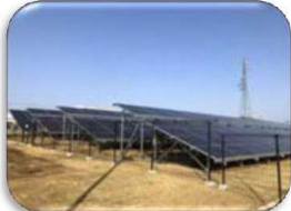
太陽光発電所 定格240kW
