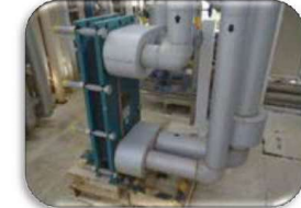
廃熱回収用熱交換器
