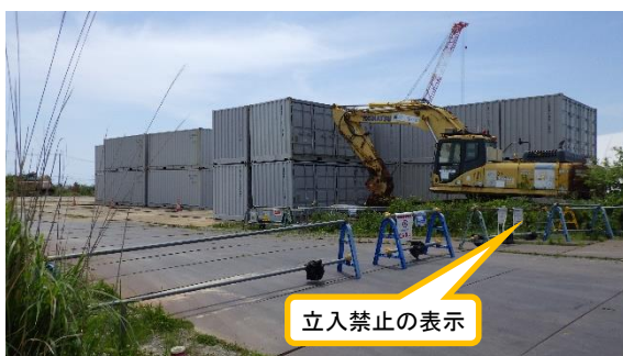
(写真1-2) 入口の立入禁止措置の状況 (北西側から撮影)
