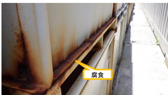
(写真3-2) 腐食したコンテナの状況 (エリア西側)
