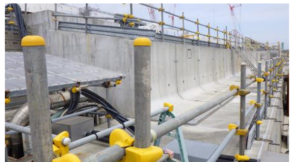
(写真1-2) 千島海溝津波防潮堤海側 (4号機タービン建屋側) の状況 (今回撮影)
