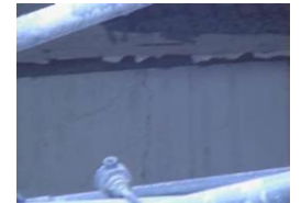
遠隔カメラ調査 (3号機4階 使用済燃料プール壁 2011年9月)
