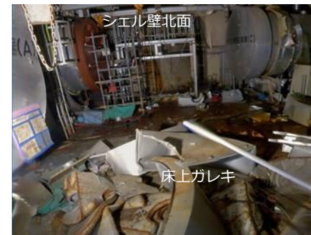
2階シェル壁北面と北側床上ガレキの状況
