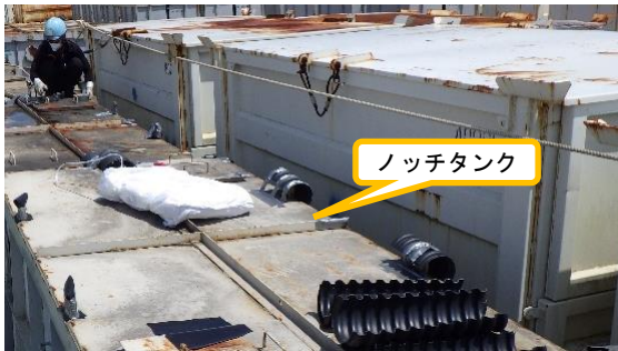
(写真2) ノッチタンクを雨除け用のシートで 覆うための準備作業の状況
