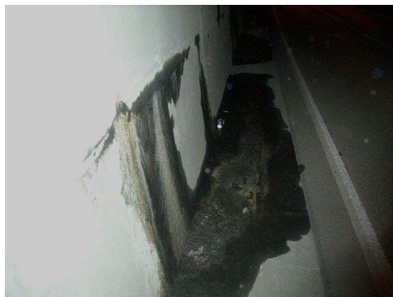
写真 4-1 漏水箇所の坑内粉塵の付着事例
