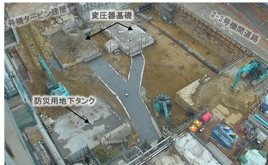
燃料取り出し用構台設置準備作業 (2号機原子炉建屋南側ヤード状況)
