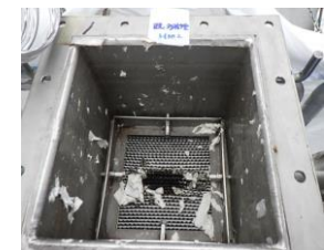
今回損傷が確認されたフィルタ
