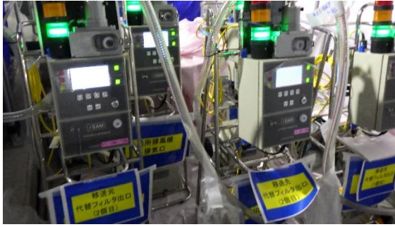
(写真4) 連続ダストモニタの稼働状況
