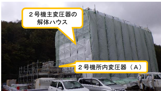
(写真1-1) 2号機主変圧器及び2号機所内変圧器(A)の状況(令和3年10月26日撮影)
