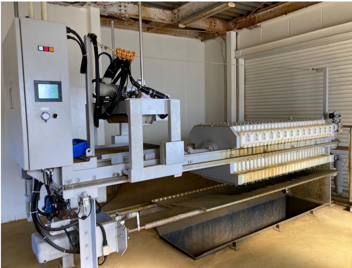
更新後のフィルタープレス
