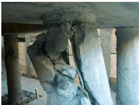
既設PC杭破損状況
