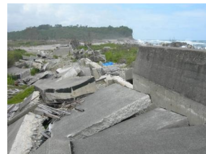
写真2 海岸被災状況(楢葉町)
