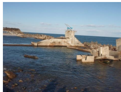
写真1 海岸被災状況(南相馬市)
