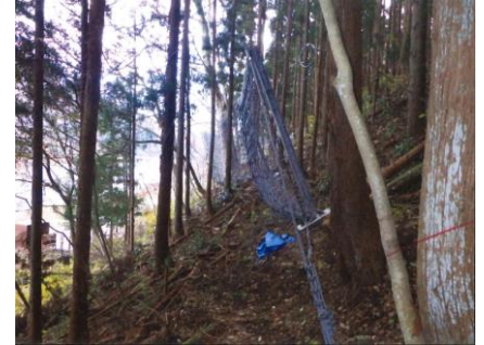
高エネルギー吸収型 落石防止柵工
